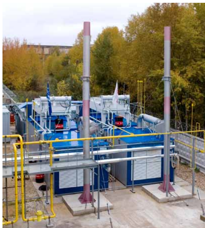
Рис. 1. Газопоршневая электростанция FG Wilson PG1250B, установленная на заводе «ТверьСтеклоПластик»
